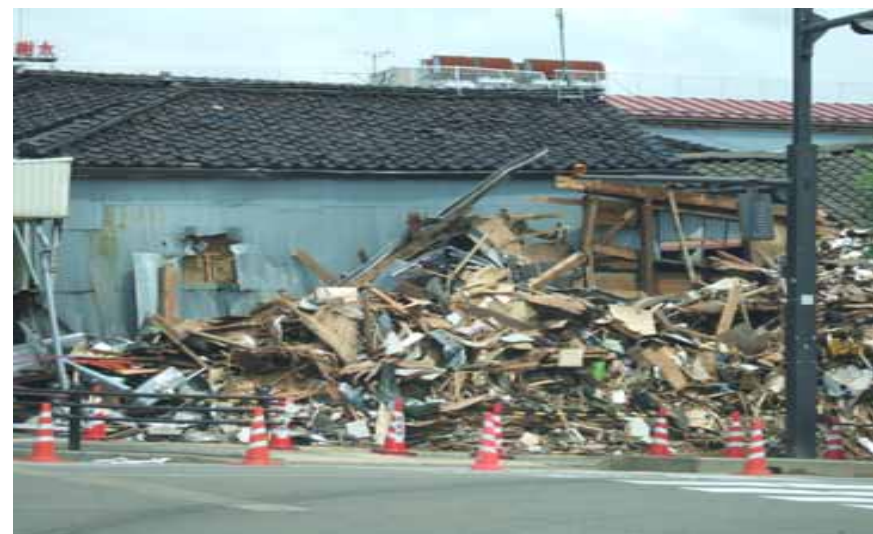
倒壊した家屋
